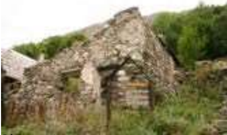
Bâti en ruines
