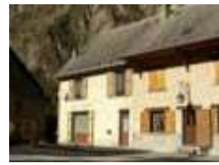
À gauche, les ouvertures ont été modifiées, les linteaux bois sont un pastiche, les volets ne sont pas peints et l'enduit est un crépi façon "rustique" non traditionnel.
