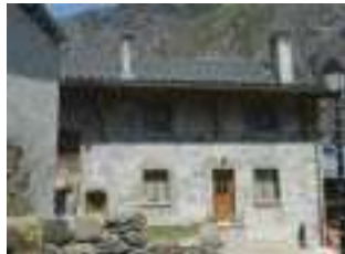
Cette façade fortement modifiée a perdu ses volets en bois et son séchoir qui sont des éléments typiques. L'enduit au ciment va à terme dégrader la maison (maintien de l'humidité dans les murs).
