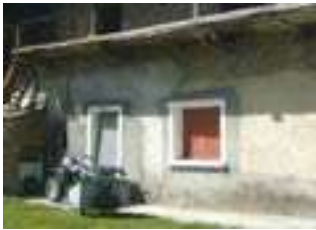
La modification des ouvertures est maladroite et dégrade la façade.
